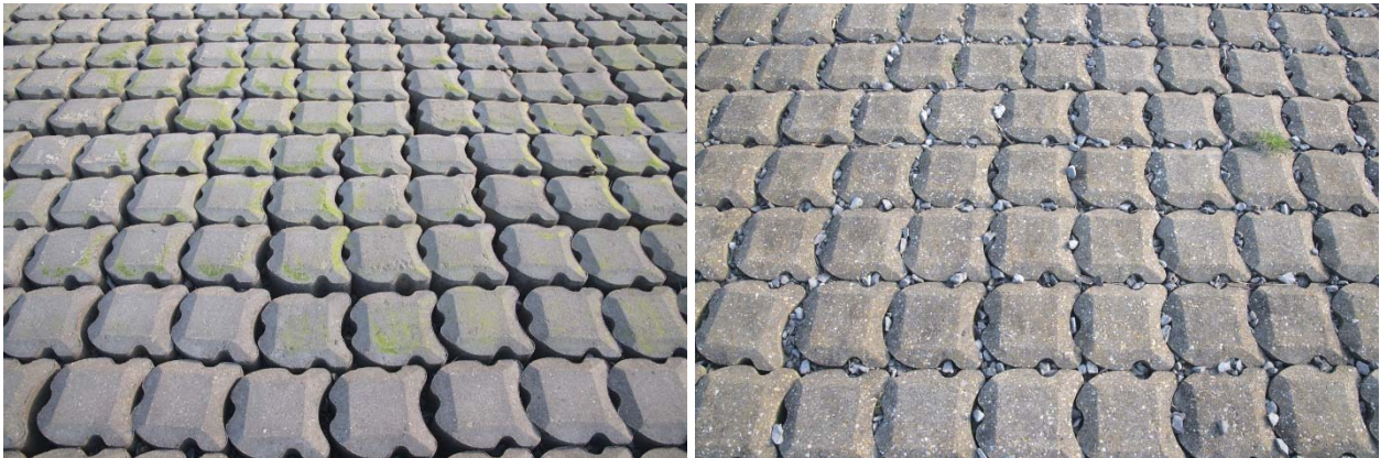
Figuur 3-7: Inwassing van een gekamde bekleding (links) en hoe de inwassing hoort te zijn (rechts)
